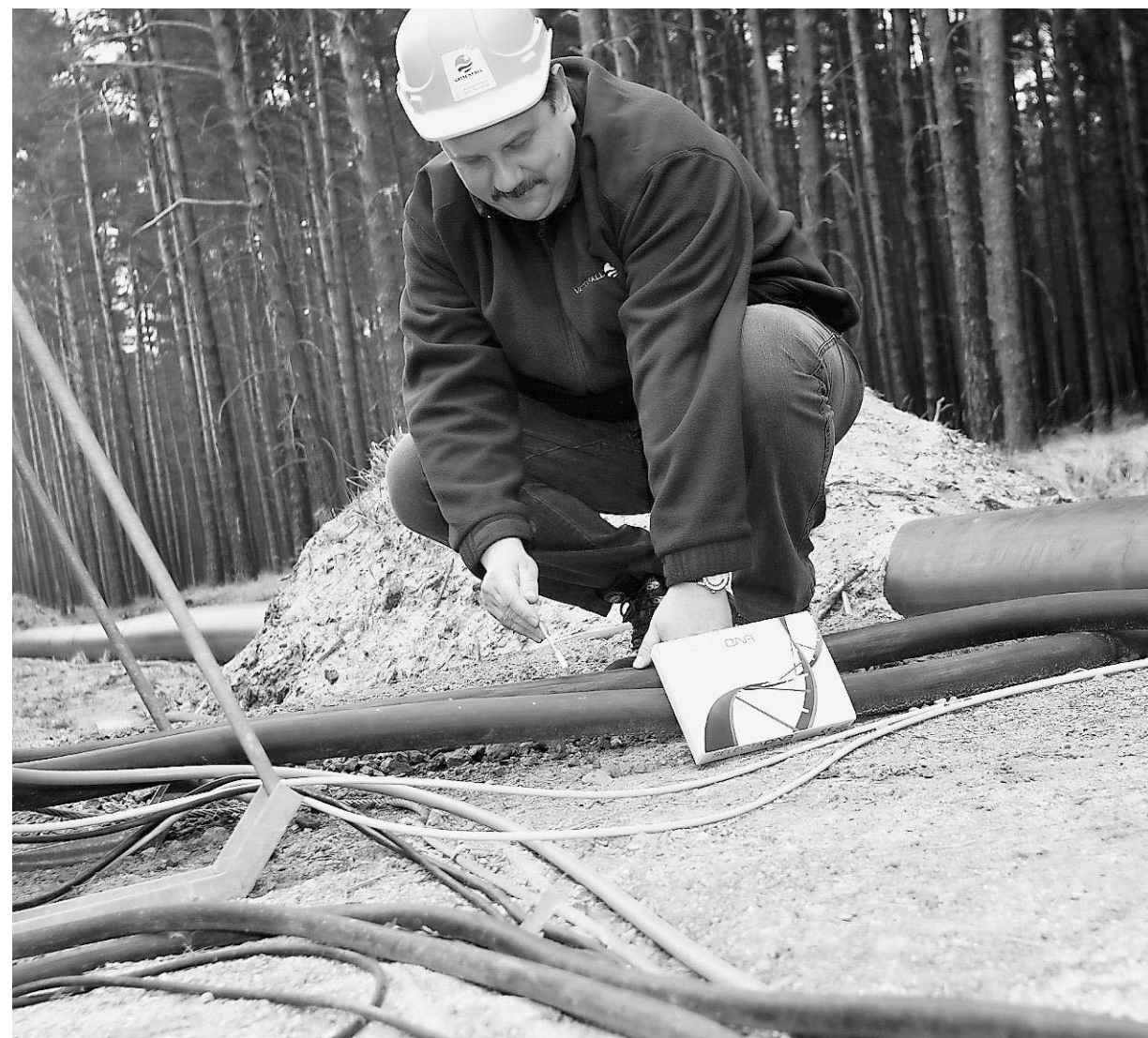
Flächendeckend lässt Vattenfall jetzt die Kabel in den fünf Tagebauen des Lausitzer Reviers mit künstlicher DNA markieren. Foto: Hartmut Rauhot
